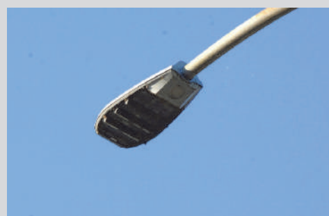
図4-39：坂月川周辺においてルーバーが設置された道路照明。
